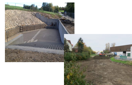
Moderner Hochwasserschutz und Ausbaggerungen der Flutmulde dienen zur Gefahrenabwehr.
