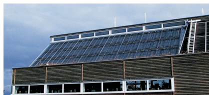
Paartalhalle mit Solardach zur Energieeinsparung
