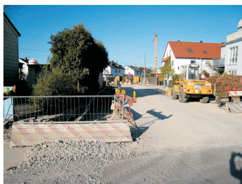
Unser Kanalsystem wurde verbessert
